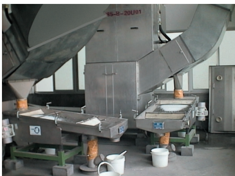
AERO-Trockner in einem Produktionsbetrieb
